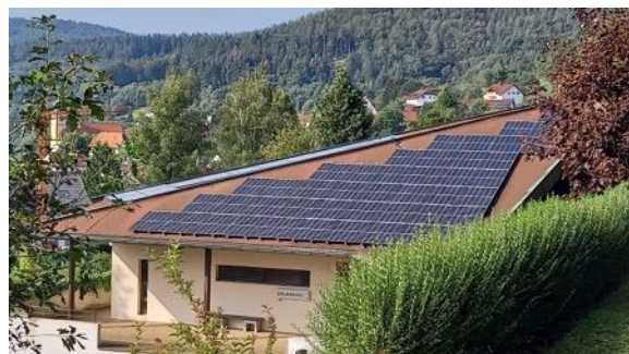
Gesamtausgabeleistung: 60 kWp 166 Solarmodule, 415Wp, 30mm, schwarz Spez. Jahresertrag: 914,57 kWh/kWp
