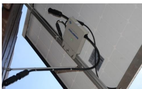
Der Wechselrichter auf der Rückseite mit Kabel zur Steckdose
